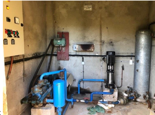
Installation de pompage de Fontenay-sous-Fouronnes :
